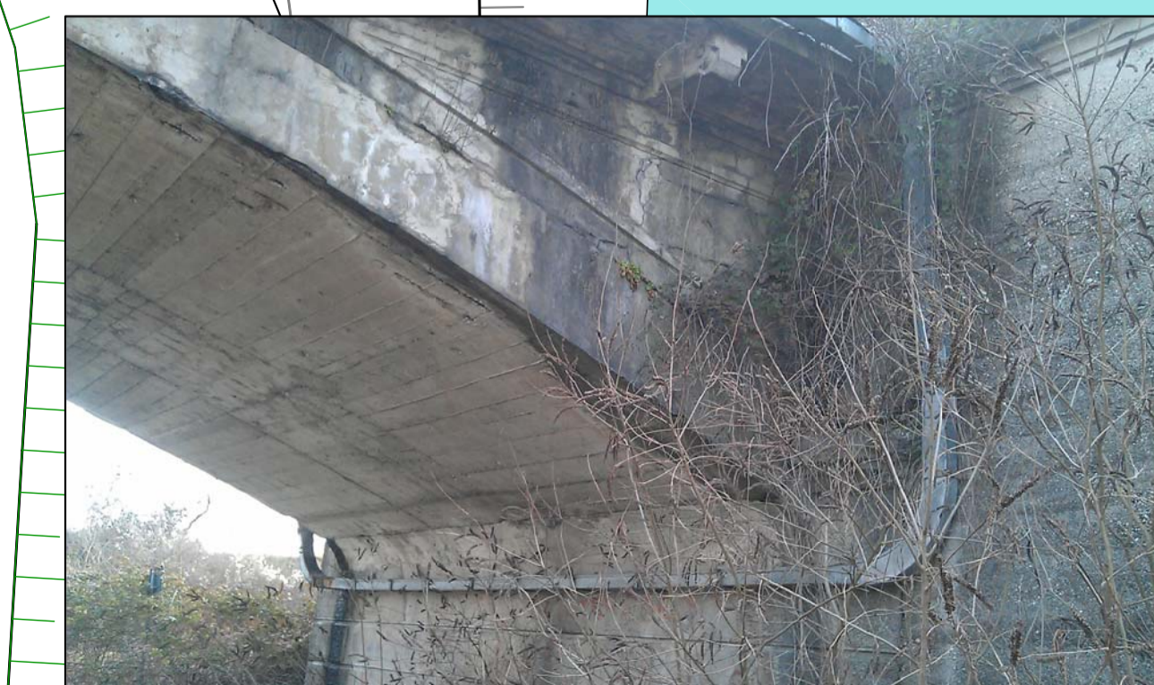
FOTO 4 - attraversamento ponte con canale in estradosso (linea TELECOM)
