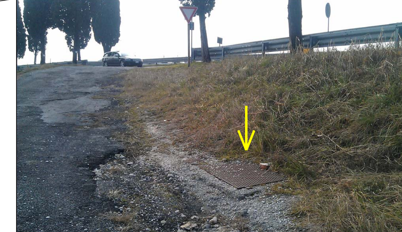
FOTO 3 - pozzetto ispezione linea TELECOM
