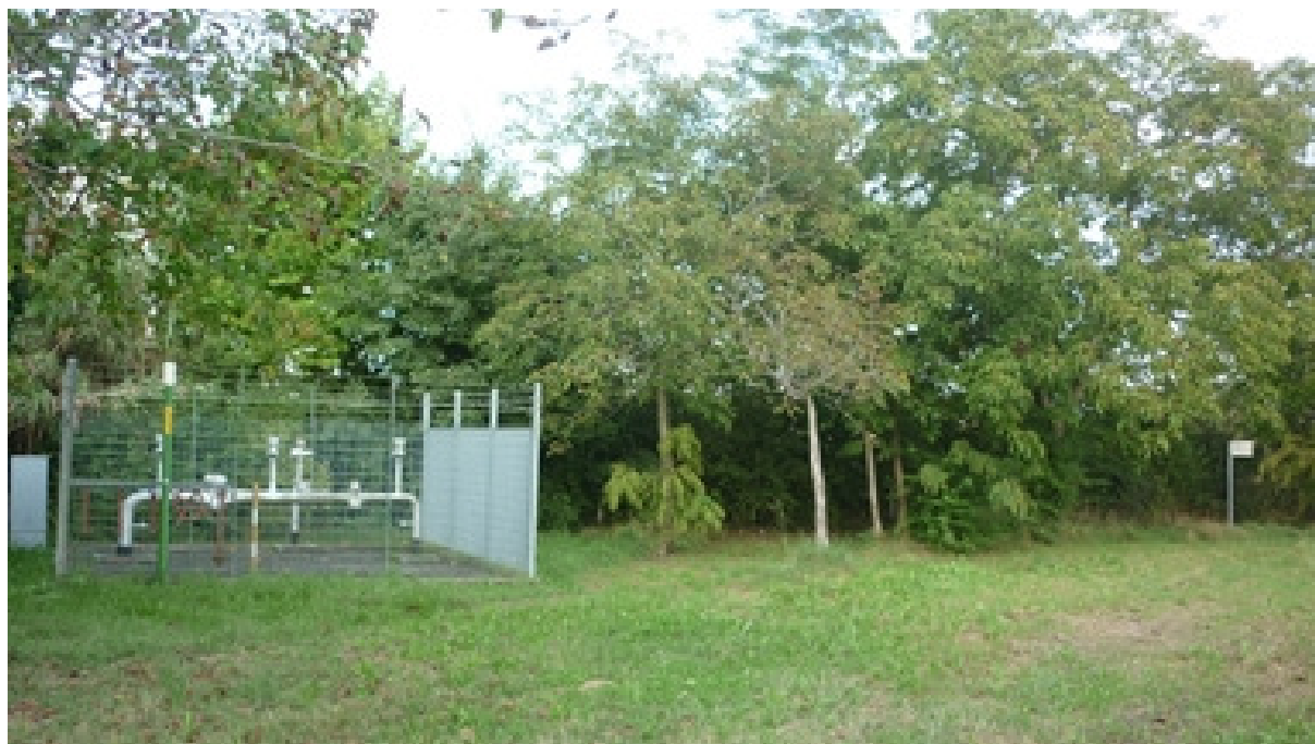
Foto 7: Stazione metanodotto SNAM 4 lato Est
