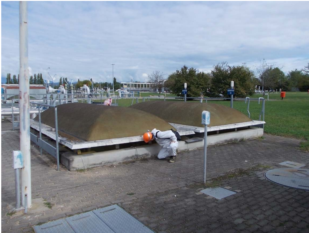
Figura 2-F – Foto Serbatoio raccolta soluzioni acquose dal circuito acque industriali.
