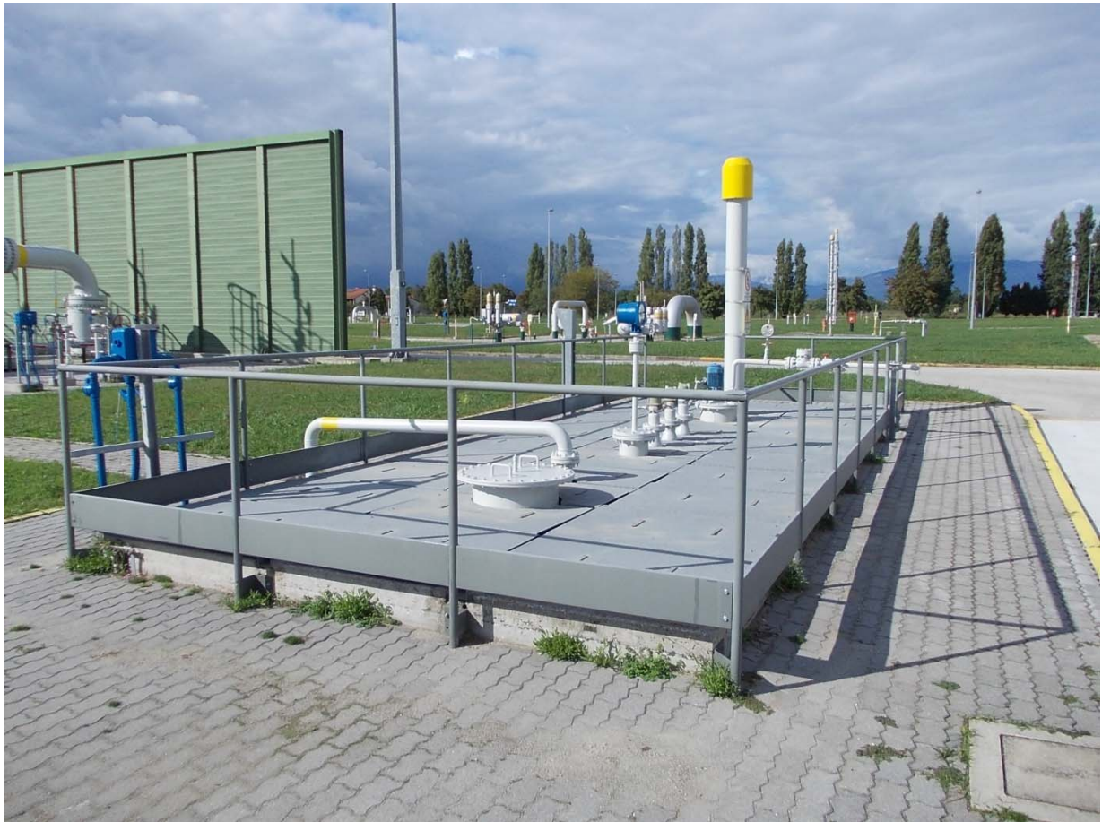
Figura 2-B – Foto serbatoio esistente Slop V-10.
