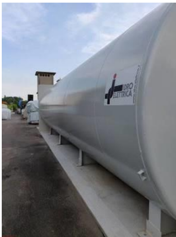
Foto 6 - Cisterna riserva acqua a fini antincendio
