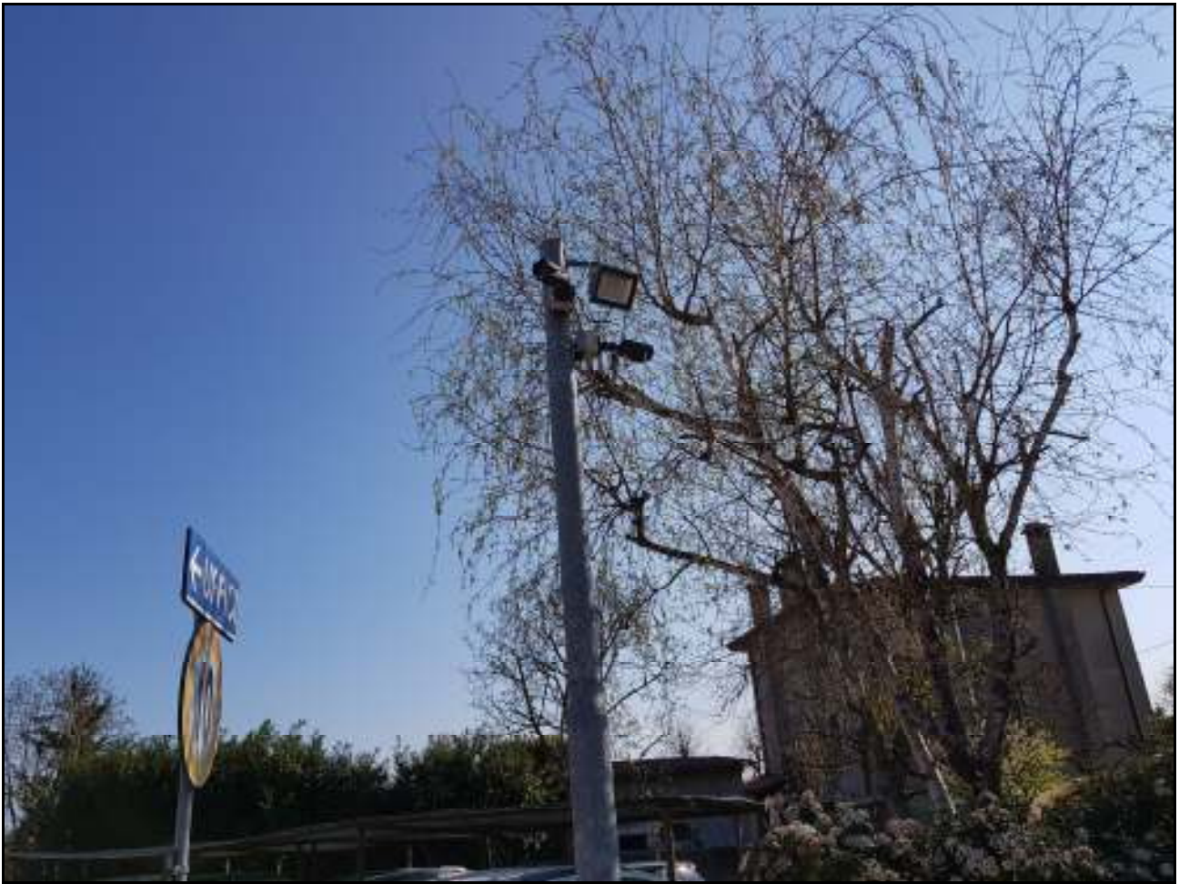
Foto 2: Punto 1 ingresso ditta - illuminazione a led durante le ore notturne (faro rivolto verso terra)
