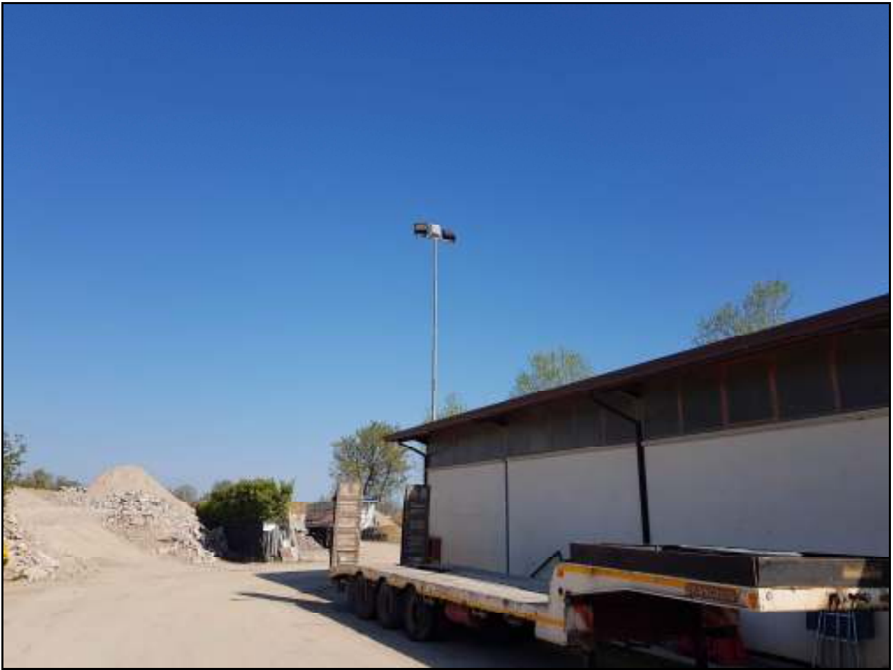
Foto 6: Punto 3 torre faro – utilizzata manualmente e saltuariamente (massimo 2 ore in inverno tra le 17 e le 19) vista da Ovest
