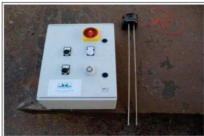
Quadro elettrico e sonde rilevamento oli
