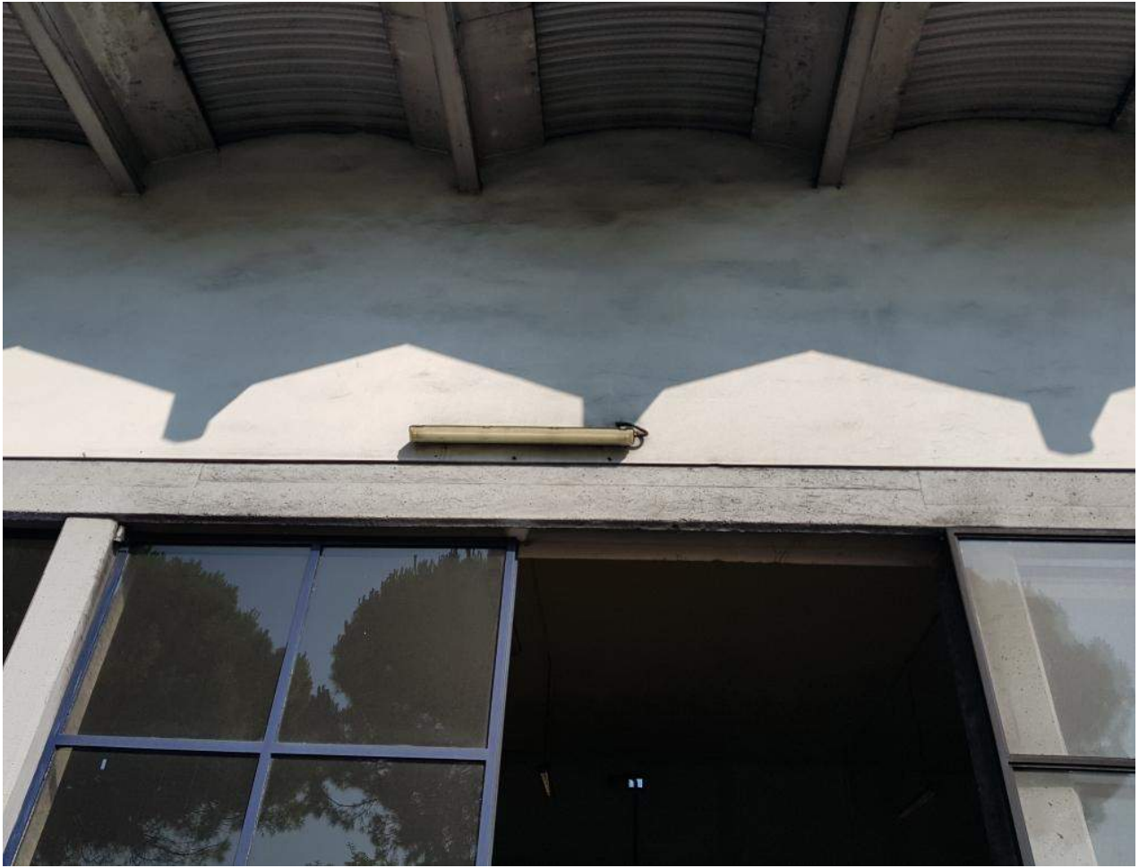
Foto 1 Illuminazione al neon lato est, portone di ingresso, normalmente spenta.
