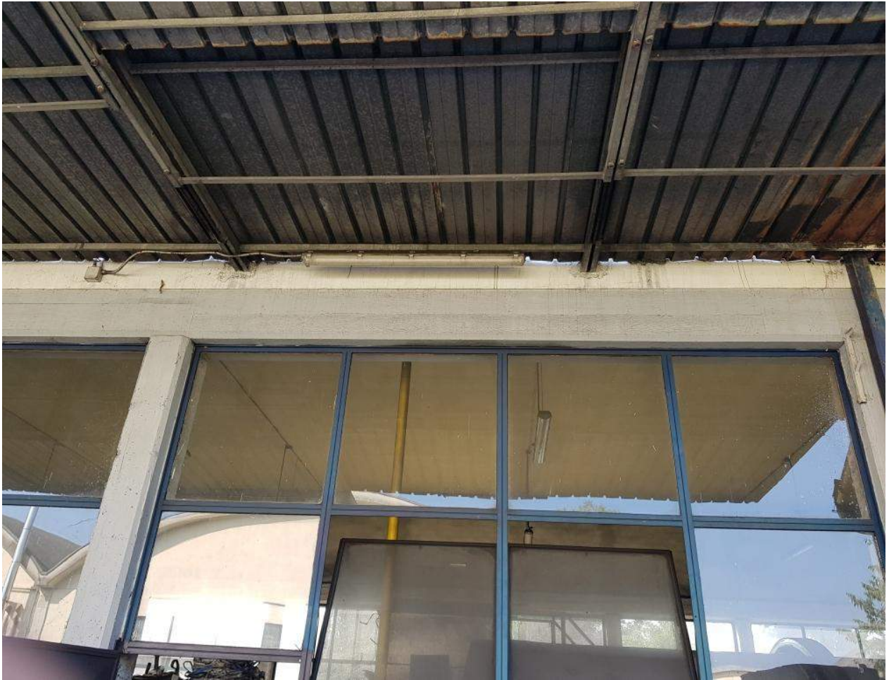
Foto 3 Lato ovest, illuminazione al neon, accensione manuale, normalmente spenta. Protetta da tettoia
