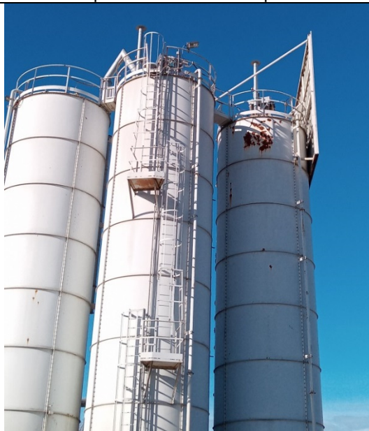
Foto 3: corpi illuminanti silos impianto linea 2
