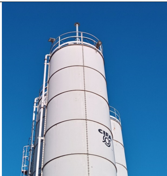
Foto 1: corpi illuminanti silos impianto linea 1
